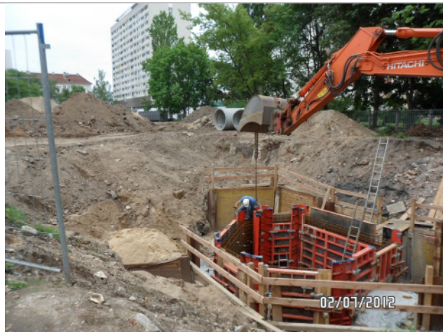
Foto 2: Ansicht LOS 8 MW- Sammler
