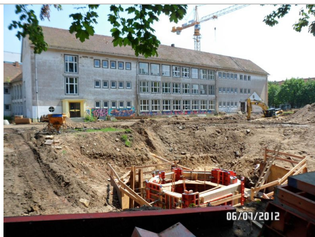
Foto 4: Ansicht LOS 8 MW Sammler
